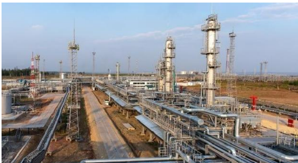
Компрессорные установки Ярактинское НГКМ
